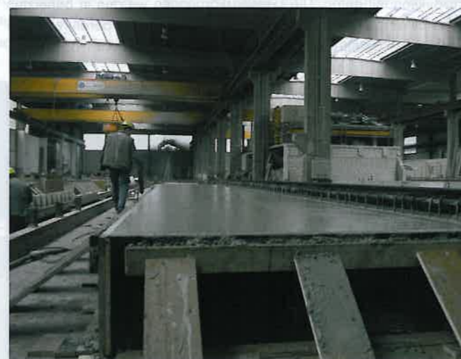
Auf den Tischen mit Stahl- oder beschichteten Holzoberflächen werden zum Beispiel Wände mit glatten Sichtbetonoberflächen gefertigt
